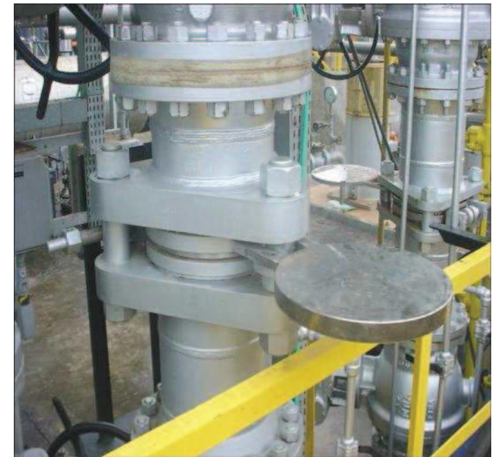
eingesetzt in HDS Anlage
