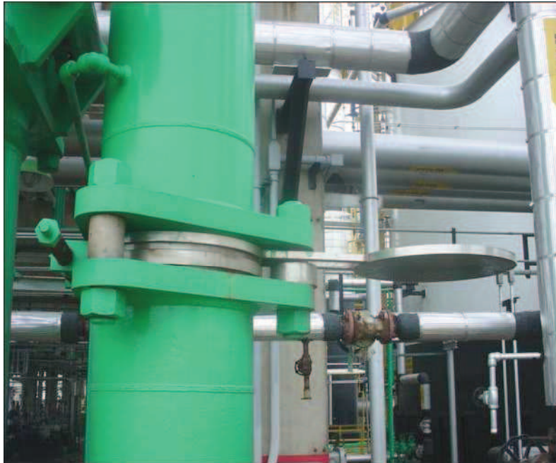
eingesetzt in HDS Anlage
